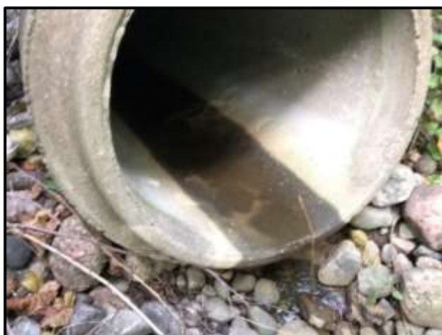
Figur 10. Utloppskulvert som leder ut vattnet från dagvattendammen mot Lillsjön.
